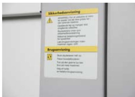
Der er monteret tydelige instruktioner for brug og sikkerhed.
