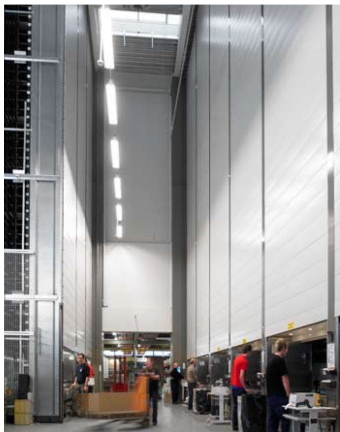
Til højre ses de 6 Tornado Double Automater der indgik i den første installation. Til venstre de 3, der blev monteret i 2007. Automaterne er 15 meter høje.
