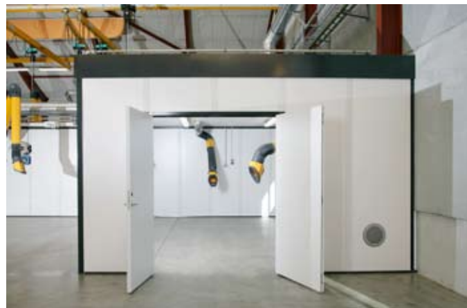
Et kig ind i den lukkede svejskabine. Man kan anvende loftet på kabinen til opbevaring eller andet, da den tåler en belastning på 250-500 kg pr. m 2 .
